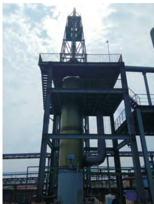
图：硫化矿尾气吸收塔
